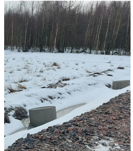
Painumaletkun pää suojakaivossa
